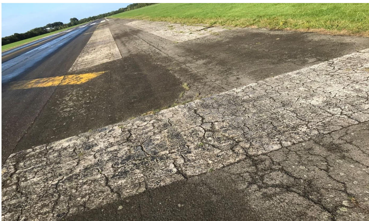
Craquelé in het asfalt op de shoulders van de start en landingsbaan
